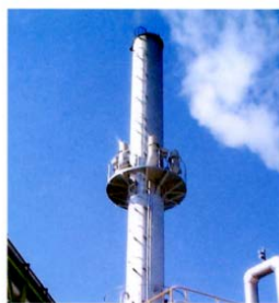
40t/hボイラー
