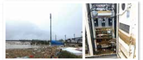
基地局の損壊
