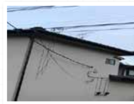
引込線の断線
